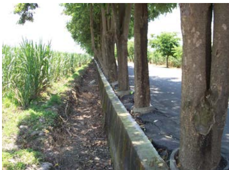
圖 17 黑板樹以圓形栽植槽及柏油路面全部封底，使植栽生長受限
