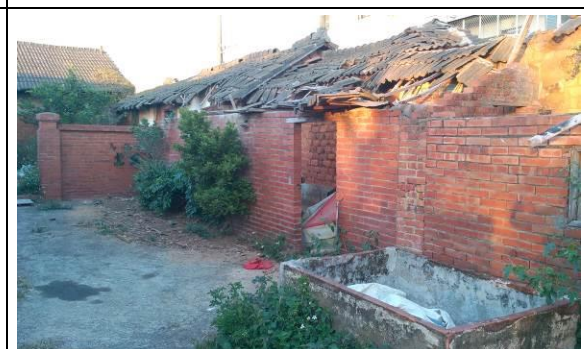
圖 4 鄉村區建築物老舊破敗
