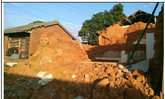
圖 3 鄉村區建築物毀損
