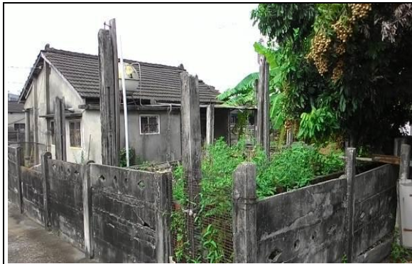
圖 1 鄉村區破舊建築
